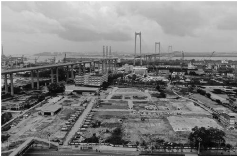
近日，中煤江南建设发展集团有限公司（广东煤炭地质局）珠海分公司中标广州黄埔双沙旧改项目42号地块桩基及基坑支护工程，合同造价约1.7亿元。该项目基坑面积约4万平方米，基坑周长1350米，地下3层，开挖深度12米，广州地铁13号线横穿整个项目，将基坑一分为二，施工难度极具挑战性。 谭钰莹 摄影报道
