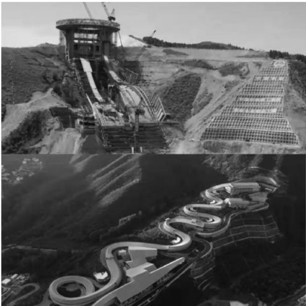
中化地质矿山总局明达海洋工程有限公司在冬奥会筹备期间,发挥优势,高质量施工,先后承担了张家口奥运村及场馆群跳台滑雪中心滑道段、看台段桩基基础、山体支护工程等多个冬奥会主要设施的桩基工程和边坡工程建设,为这场冰雪盛会打下良好基础。 朱常侠 摄影报道
