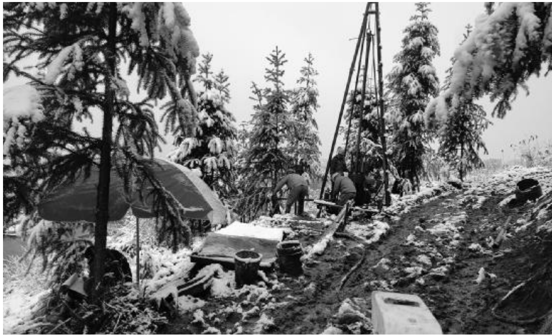
近日,江西省地质局第十地质大队天久工勘院湖南邵永铁路项目开工,22台钻机已进场,计划工作量465孔,进尺10602.89米。邵永铁路位于湖南省西南部,北起邵阳市,南至永州市,是呼南通道的重要组成部分,对缓解京广高铁长沙至衡阳段运输压力具有重要意义。黄发贵 摄影报道
