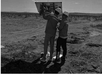
图为湖北局西北公司技术人员调试设备
