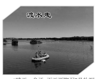
“晴天一身汗，雨天两脚泥”是物探野外施工的真实写照。在项目施工过程中，施工测线需要多次穿过泚河，随着雨季的到来，泚河水位持续升高，面对严峻的汛情，物探队技术人员迅速反应，在保证施工人员安全的前提下，采用水上泡沫放置电缆及接收仪器，水下
