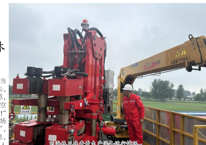
刘海林正在查看生产设备运行情况
