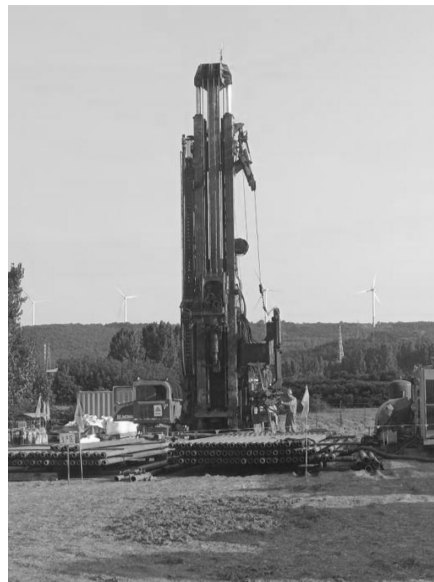
近期，总局一勘局一一九队平煤股份（东部）矿区平顶山煤层气采动井项目进展顺利。SSCD-28井6月24日开钻，28日顺利完成一开钻进、下套管、固井等工作任务，钻井深度127米。SSCD-27井钻井设备已进场，正在进行井场标准化建设。该项目共计4口煤层气采动井，工作总量3600余米。项目的实施，将有效实现先采气、后采煤，减少目的煤层瓦斯突出风险，降低煤矿瓦斯事故发生概率，提升煤矿产能，同时开发利用清洁绿色能源，变害为宝。
