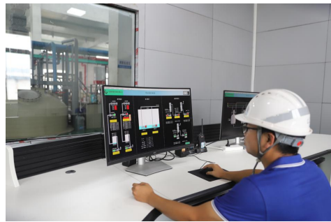
生产管理员在自动控制室监测生产运行情况
